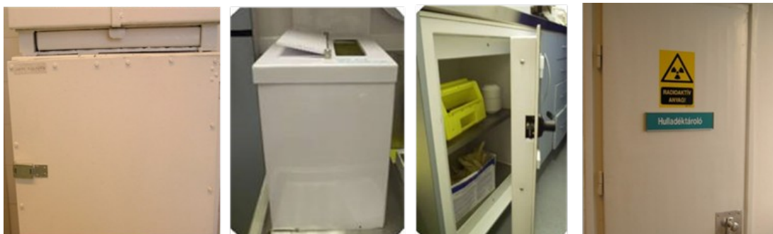
4. ábra. Napközben keletkező radioaktív hulladék gyűjtésére szolgáló tárolók, radioaktív hulladéktároló
